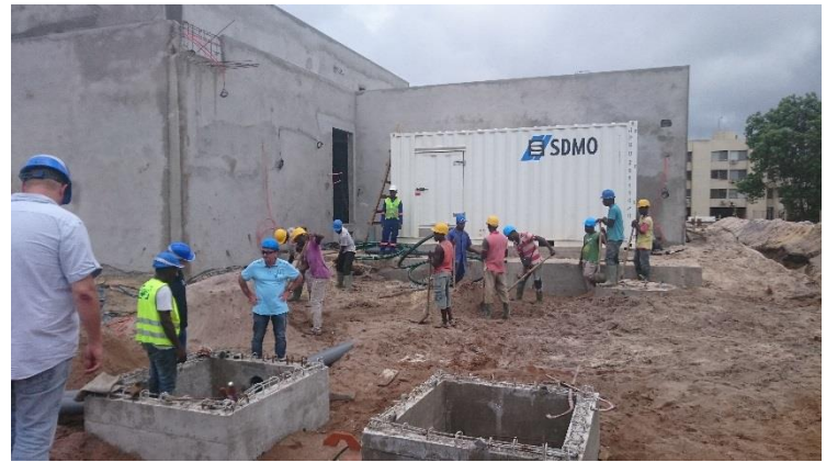
Ilustración 1: Proceso de instalación de ambos grupos electrógenos de 1400 kVA en el centro.
