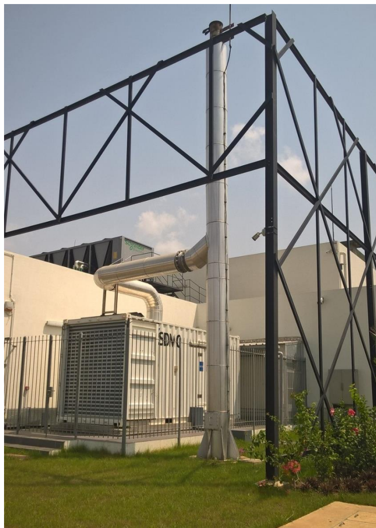
Ilustración 3: Vista de uno de los dos grupos electrógenos de 1400 kVA instalados cerca del centro de datos.
